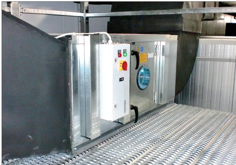
In die Schächte der zentralen Klima- und Lüftungsanlage integrierte UV-C-Luftentkeimungsmodule „töten“ Mikroorganismen bis zu 99,99 Prozent ab
