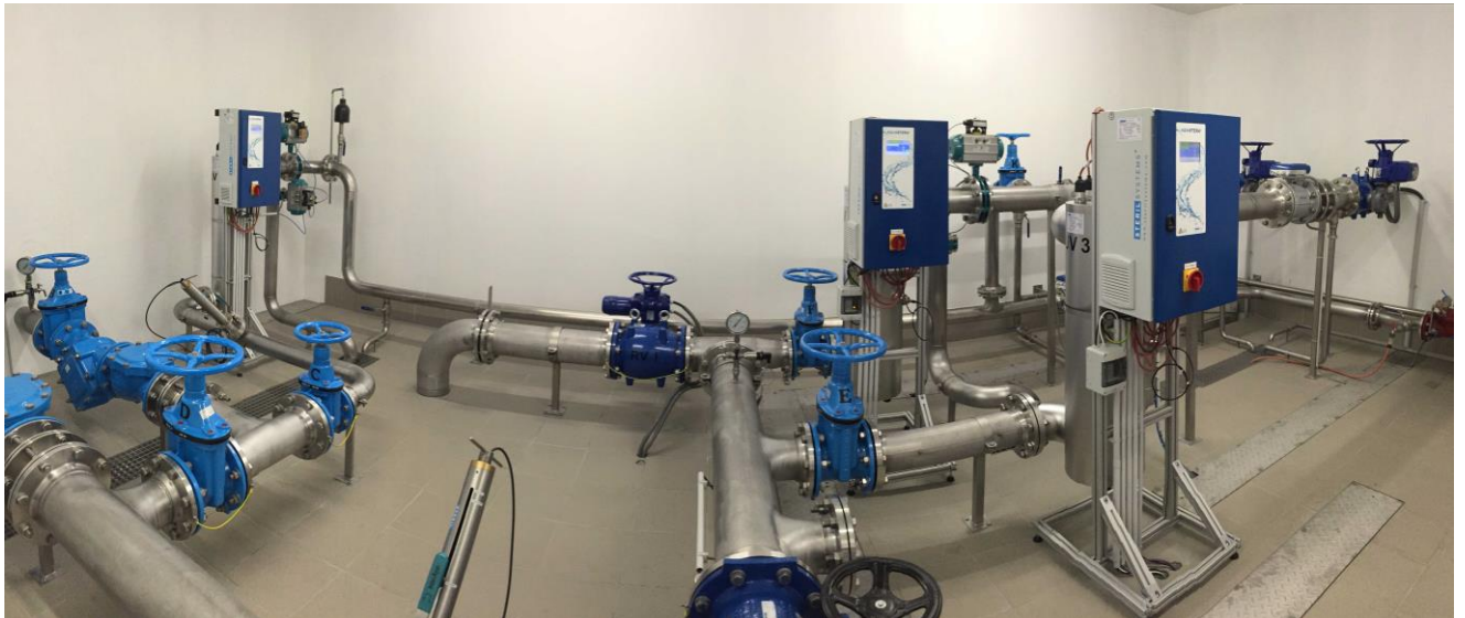
Drei in die Wasserversorgungsanlage integrierte AQUASTERA-UV-C-Desinfektionssysteme stellen eine nachhaltige Trinkwasserqualität sicher
